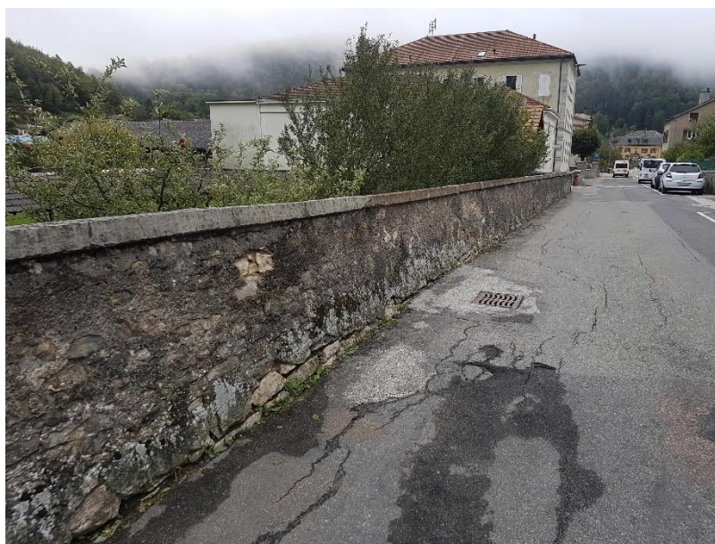
Figure 2: Dégâts existants sur le mur : fissures sur les enrobés, dans la base du mur en pendage vers l'extérieur (Source : VBI SA)
