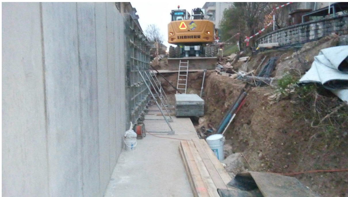
Figure 12: Exemple de talus constructifs à l'arrière d'un mur de soutènement (Source: VBI SA)
