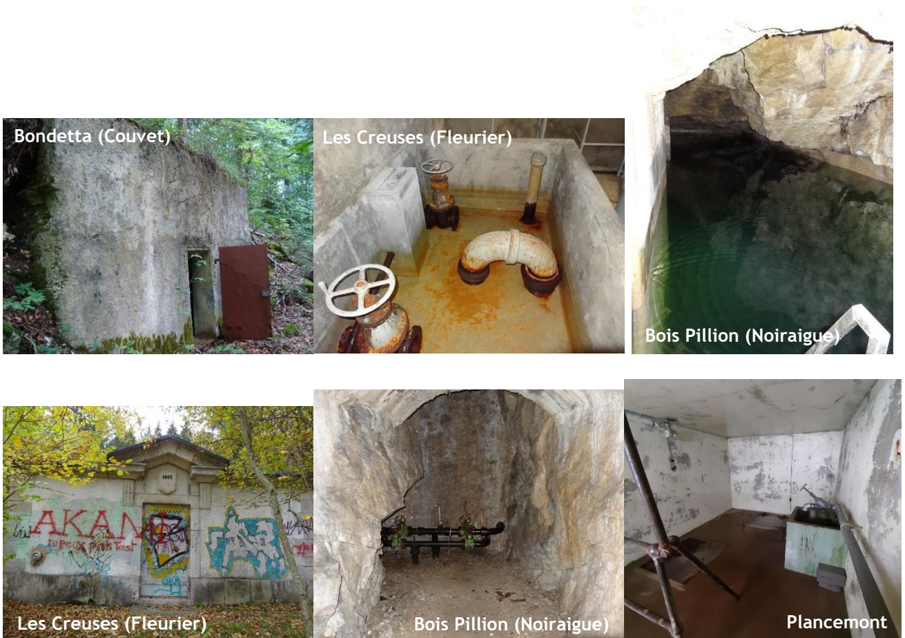
Figure 16 : photos de réservoirs
